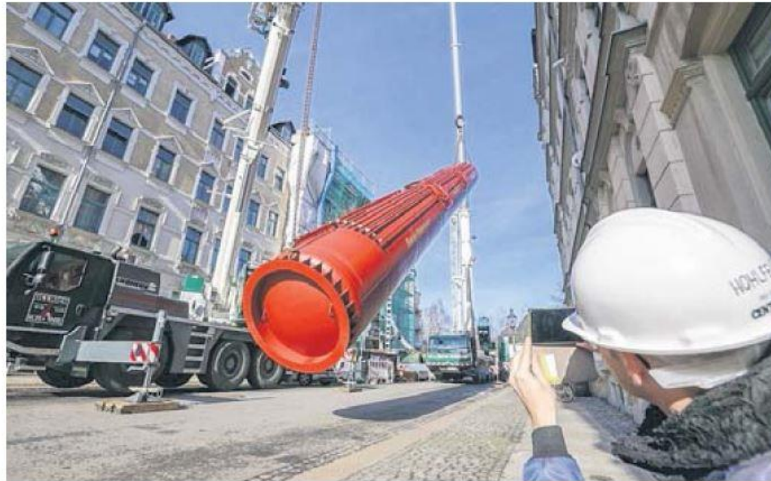
Der längste Solarschichtenspeicher im Mehrfamilienhaus in Chemnitz wird gesetzt. Im Bild der längste Solarschichtenspeicher wird in ein Mehrfamilienhaus an der Dorotheenstraße gehoben. Foto: Toni Söll
