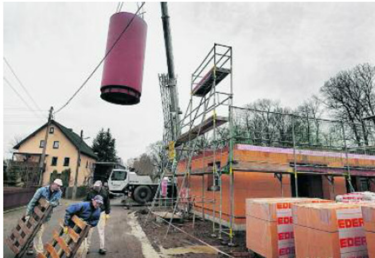
Auf der Berthelsdorfer Straße schwebte gestern der Wärmespeicher für das erste Energetikhaus in Hainichen ein.
