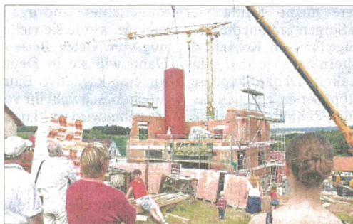
Der Riesen-Solarspeicher schwebt über den Haus.
