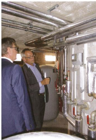
FASA-Vorstand Ullrich Hintzen erklärt Sachsens Umweltminister Frank Kupfer (l.) das „Herzstück“ der Wärmeversorgung des sanierten Hauses.
