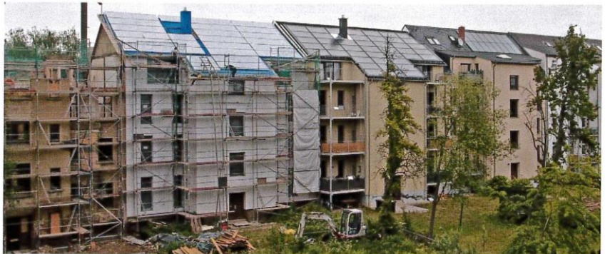
Die Rückseite der Gebäude mit Solarkollektoren auf dem nach Süden ausgerichteten Dach und einer Dämmung von lediglich 10 cm.
