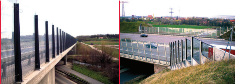
A73 in Franken Transparente Lärmschutzwand aus Acrylglas auf Brückenkappe
