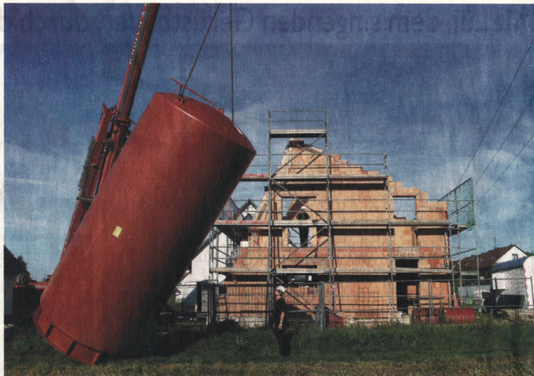
Das erste „Energetikhaus 100“ Bayerns entsteht in Puschendorf: 27000 Liter Wasser fasst der Tank, der am Mittwoch mit einem Kran in den Rohbau gehoben wurde. Der Tank reicht über zwei Stockwerke. Foto: Wraneschitz
