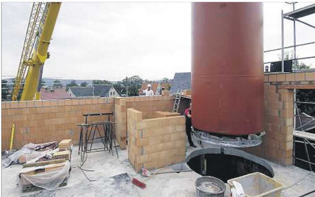
Ein in der Schweiz produzierter, haushoher Langzeitsolarspeicher wurde gestern in der Neustädter Gartenstraße in den Rohbau des ersten Ganzjahressolarhauses in Thüringen eingelassen. (Foto: OTZ/Peter Cissek)
