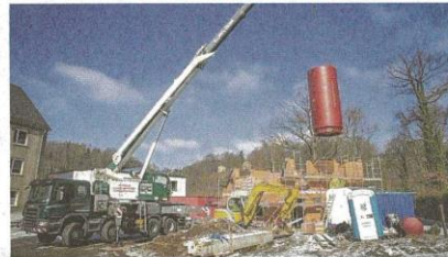
Die Bauleute benutzen einen Autoschwerlastkran, um das Herzstück des Hauses an seinen Platz zu heben.
