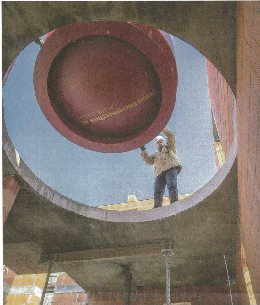
Der etwa 5,50 Meter hohe Solarspeicher bringt ein Leergewicht von 2,5 Tonnen auf die Waage. Bauleiter Lars Heckel brachte den schwebenden Koloss in die Spur.
