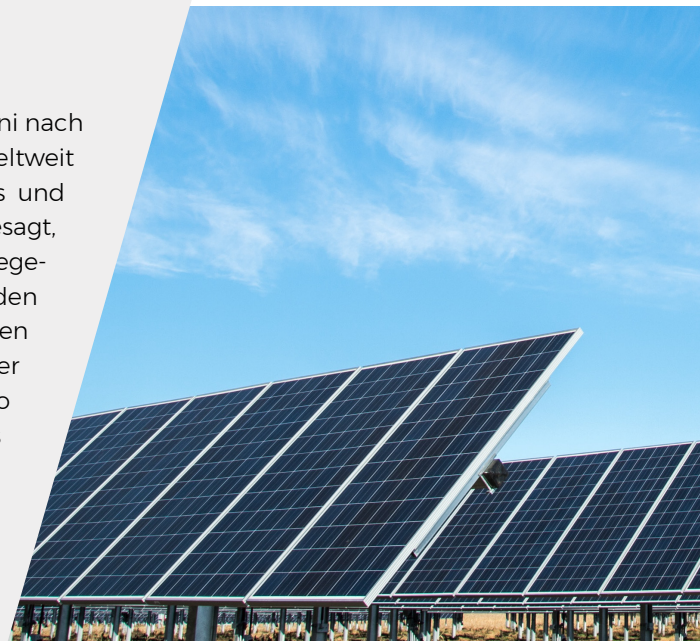
Photovoltaik-Anlage zur Stromgewinnung.
