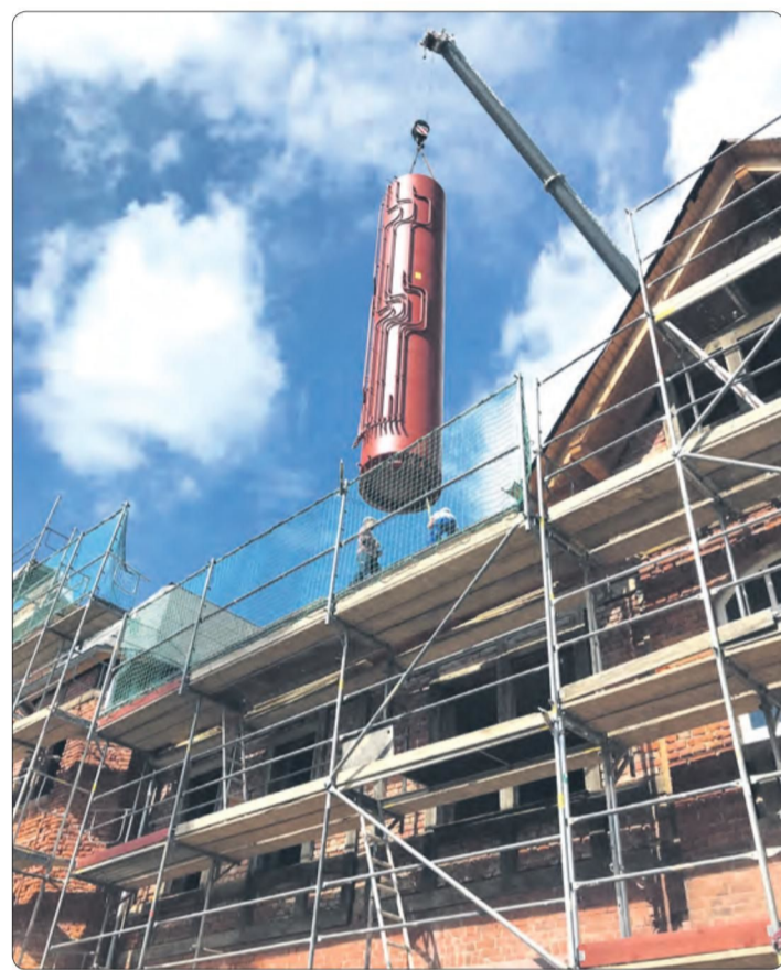
Mithilfe des großen Solarspeichers der Fasa Ag kann Solarenergie für die Heizung und die Warmwasserbereitung genutzt werden. Foto: Fasa AG
