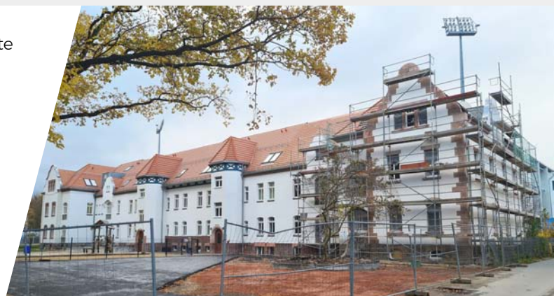
oben: Eingangsbereich der Solar-KiTa im Eschestift unten: Südseite mit Solarthermie-Anlage
