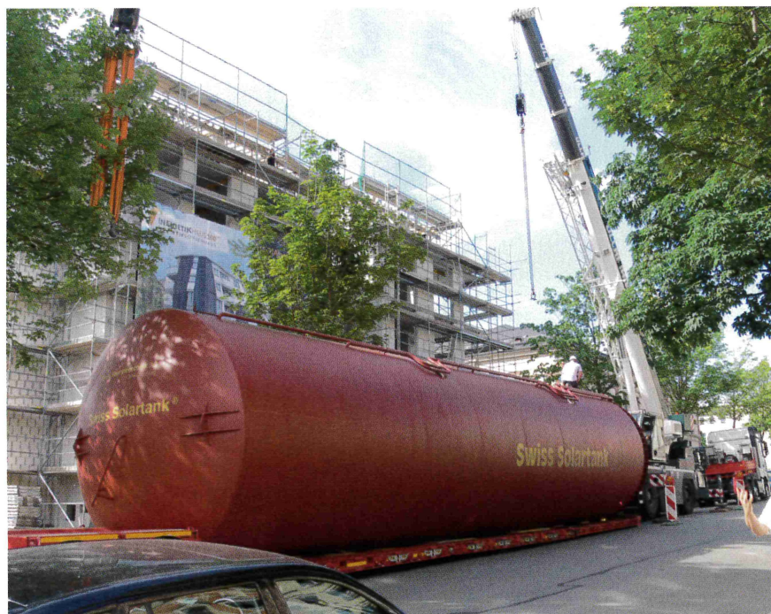
Beachtliche Dimensionen: Der Wärmespeicher von Jenni Energietechnik im Solardomizil III fasst 72 Kubikmeter Wasser und ist knapp 18 Meter hoch.
