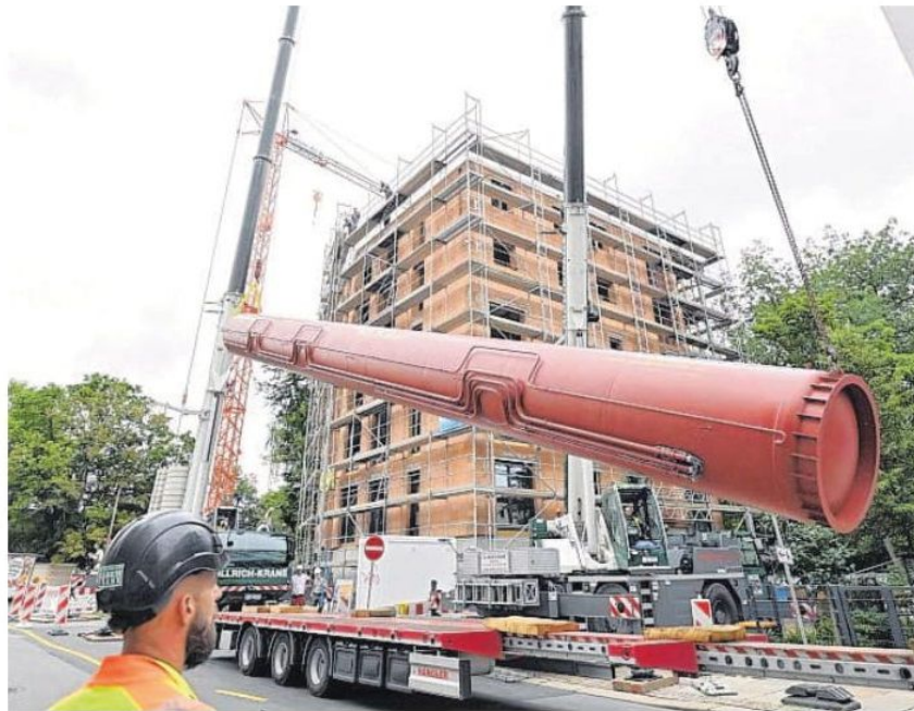
Der Warmwasserspeicher „macht sicht auf den Weg“. Foto: Andreas Seidel
