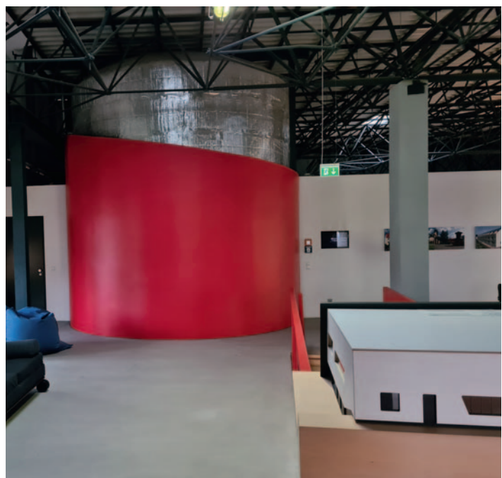
Der 110 Kubikmeter große Wärmespeicher im Firmengebäude der FASA AG ist nicht zu übersehen.
