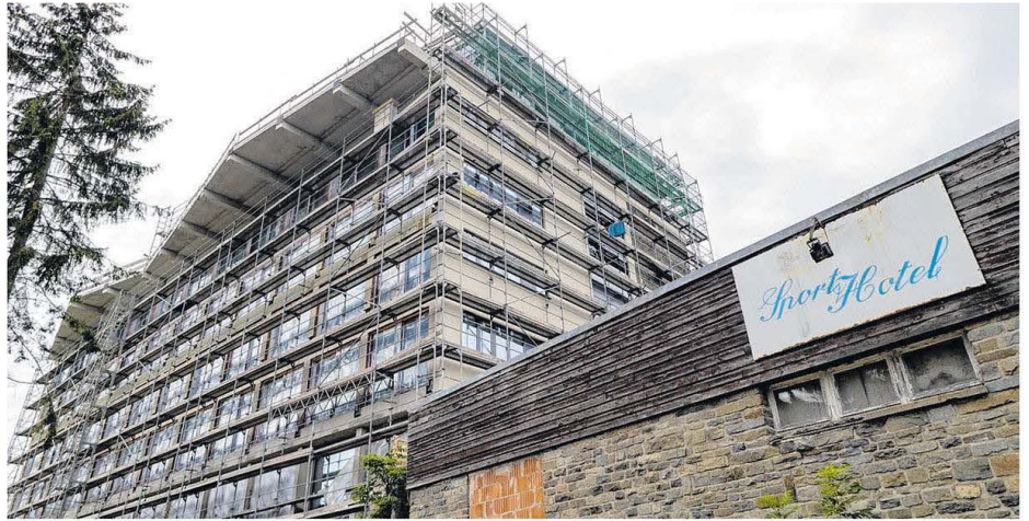
Die Bauarbeiten am früheren Wismut-Bettenhaus laufen auf Hochtouren. Noch dieses Jahr soll das Gebäude mit 70 modernen Apartments öffnen. Zuvor werden zum Beispiel im September die Balkone angebracht. Was aus der Schwimmhalle (vorn) wird, ist noch offen.
